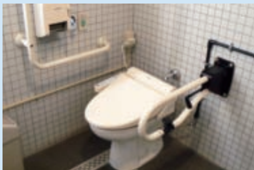
▲より快適に改良されたトイレ
