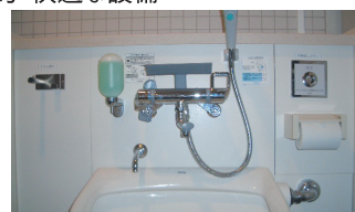
オストメイト対応設備
